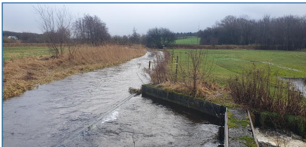
Fig 19. Vandstanden i Binderup Å er på dette billede blot ca. 5-15 cm fra oversvømmelse af dæmningen (ca. 4,6 m DVR90) ved sydlig fisketrappe, og viser at der er reel risiko for dæmningsbrud på stedet.
