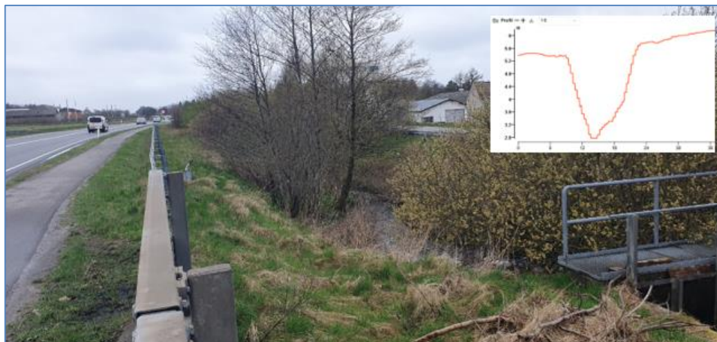
Fig 17. Omløbet tæt på Ny Nibevej ligger dybt eroderet (2,5-3,0 m) i forhold til terrænet og der ses flere steder brinkscred.
