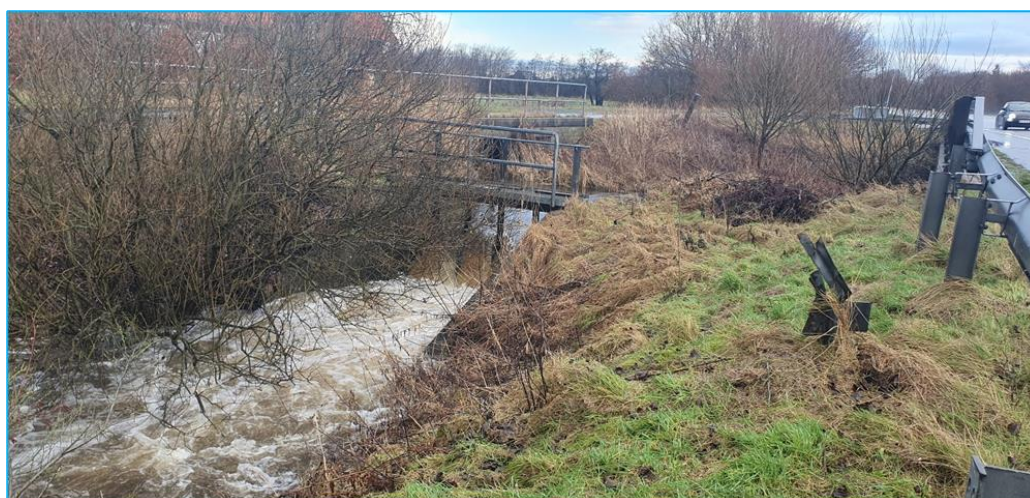
Fig 16. Reguleringsbygværk (omløb) med frit fald mellem Ny Nibevej og Gl. Aalborgvej. Det ses at bygværket aflaster meget store vandmængder og der er meget stor erosion i hele omløbets 60 meter lange forløb.
