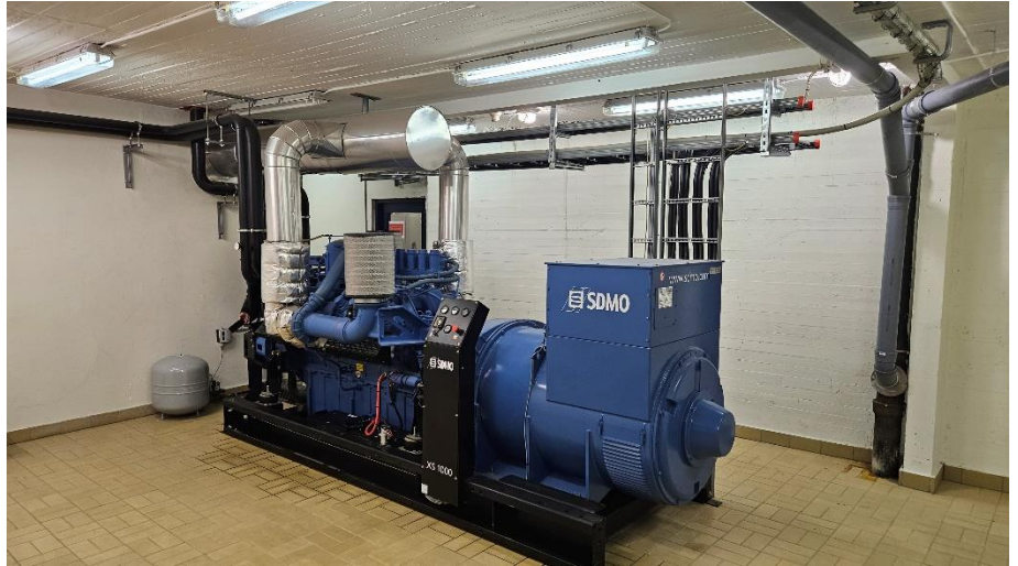
Foto af det konkrete anlæg, som forefindes installeret på Nytorv 18.
